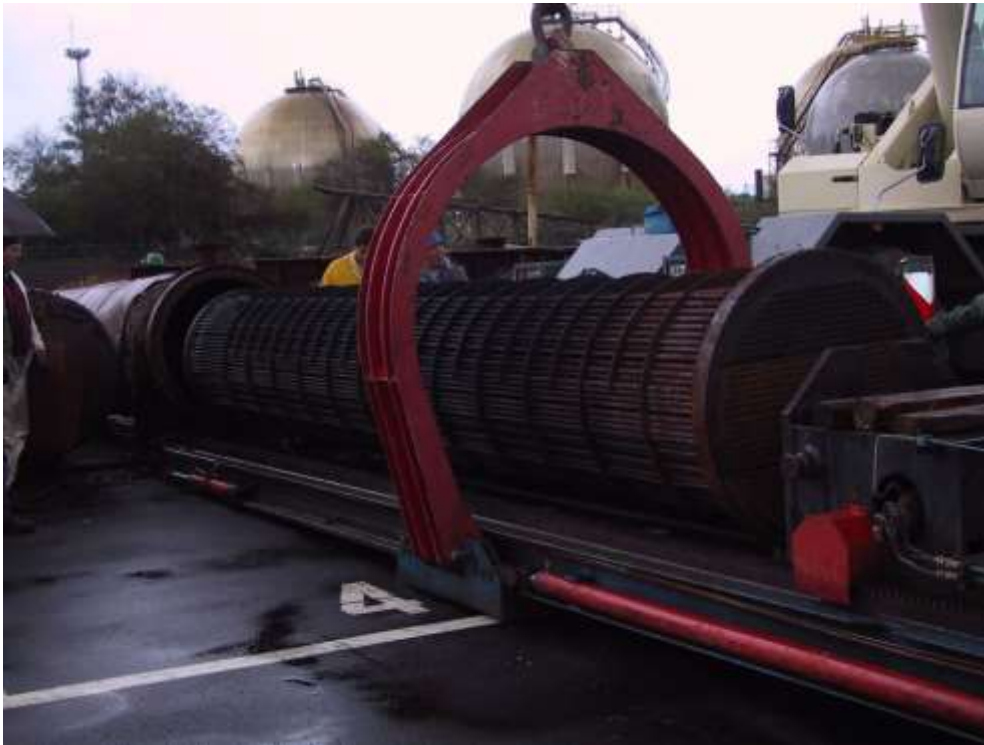
Figura 138: Fascio tubiero estratto da uno scambiatore di calore
