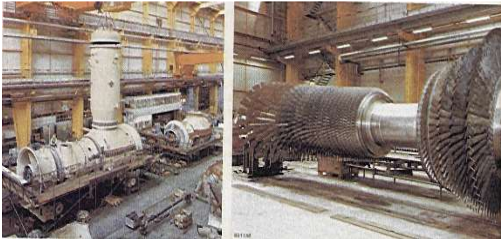
Figura 114: Impianti a gas di terra
