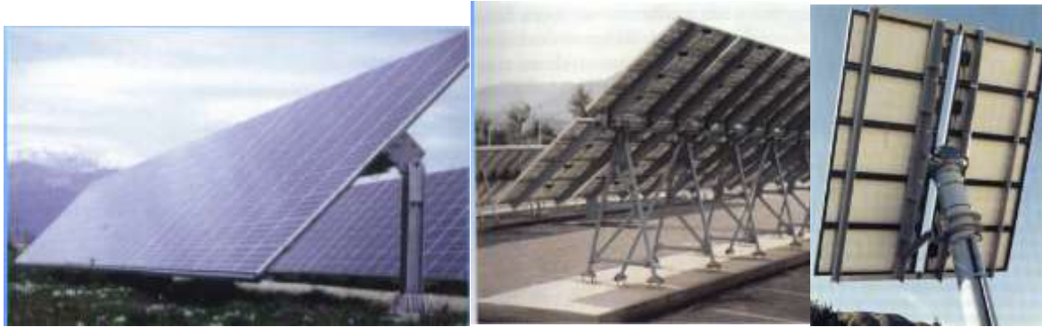
Figura 130: Tipologia di posa a inseguimento, a cavalletto, su pali
