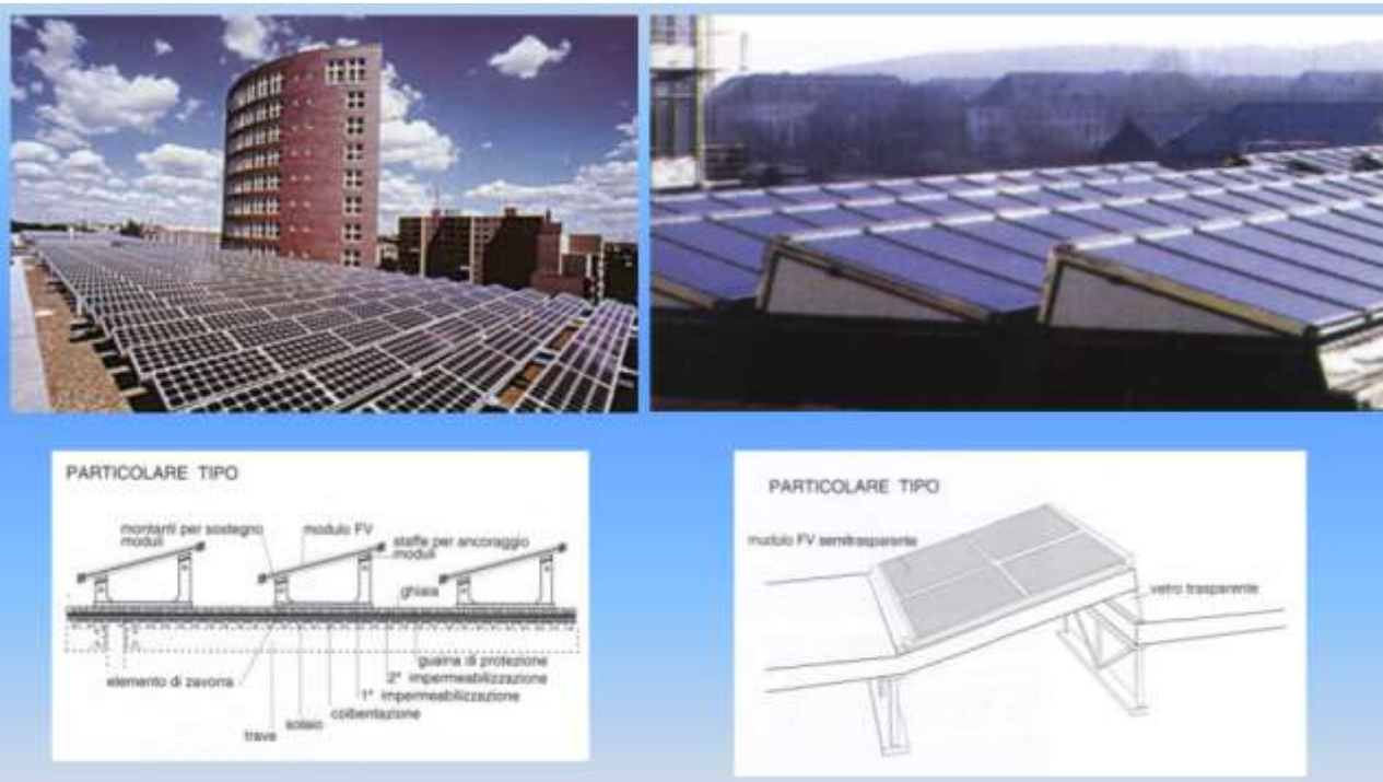
Figura 132: Particolari di installazione sui tetti
