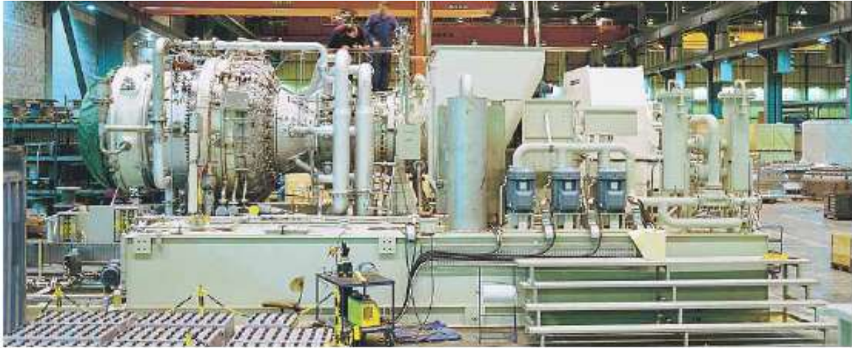
Figura 367: Impianto cogenerativo con turbina a gas : 120 kW e 146 MWe
