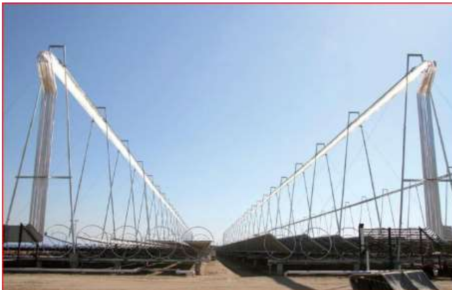
Figura 109: impianto CFLR di Kimberlina
