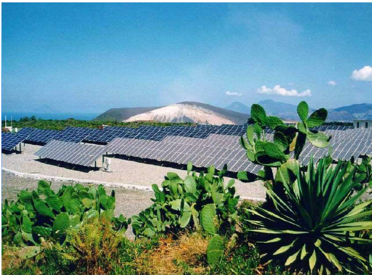
Figura 135: Installazione di pannelli nell'isola di Vulcano – Potenza 80 kWep
