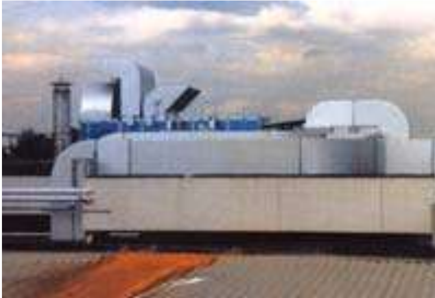
Figura 146: canali dell'aria posti fuori dall'edificio
