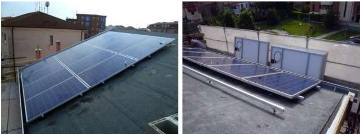
Figura 213: Dettaglio del sistema fotovoltaico integrato in copertura
