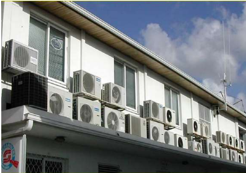
Figura 20: Impianti singoli di tipo split in un edificio
