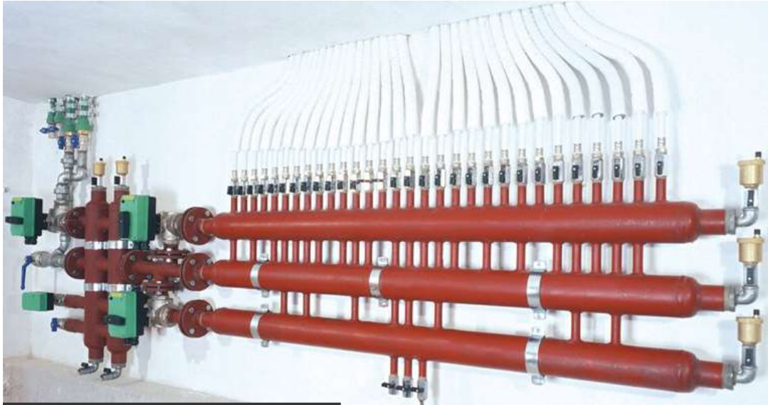
Figura 350: Esempi di collettori di centrale
