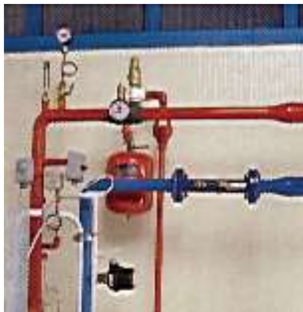
Figura 332: Foto esempio di installazione del vaso chiuso e della valvola di sicurezza
