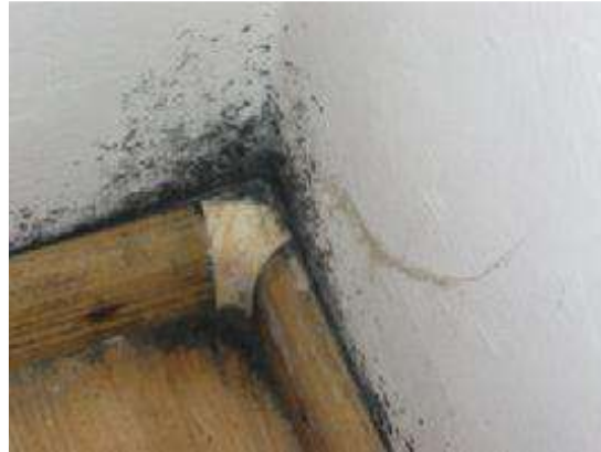
Figura 14: Formazione di condensa e muffa in corrispondenza dell'intersezione di due pareti
