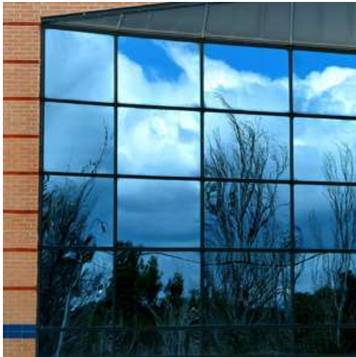
Figura 144: Finestre con filtri solari applicati all'esterno delle vetrate
